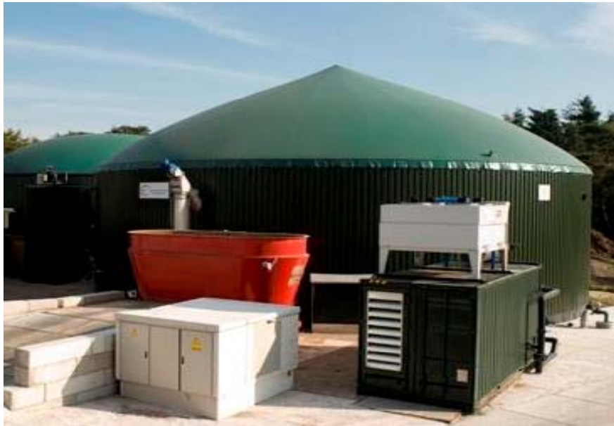
BIOGAS INSTALLATIE PROEFBOERDERIJ STERKSEL
