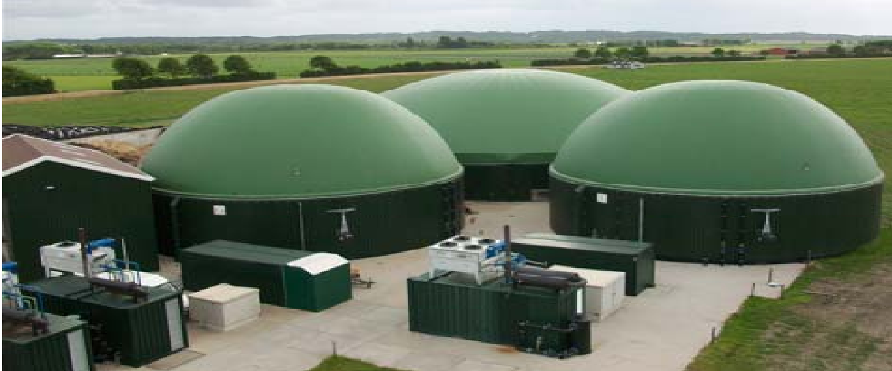
BIOGAS INSTALLATIE PRONK (WARMENHUIZEN) OORSPRONKELIJK 340 kWe, NU 720 kWe
